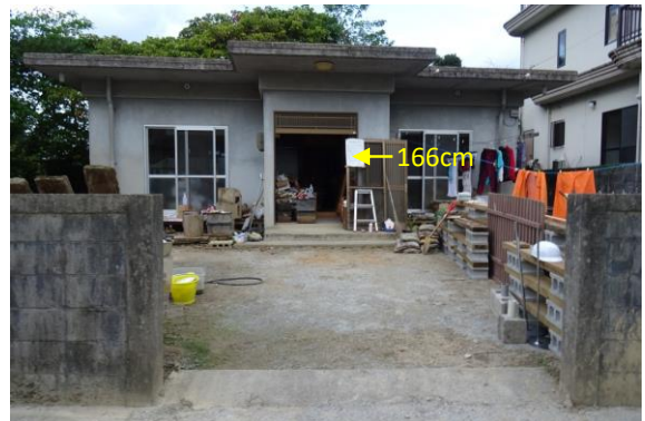
写真 2 比地地区における住宅の浸水被害
